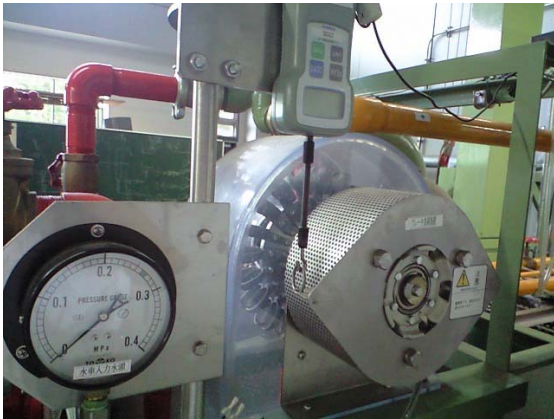
図 7 ペルトン水車 Fig.7 Pelton hydro turbine
