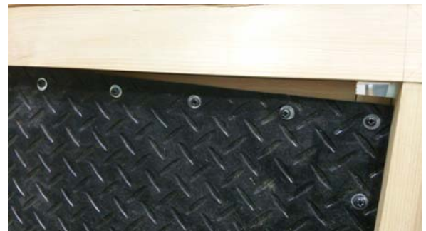
写真 2 真壁タイプ耐力壁の桟木の剥離
