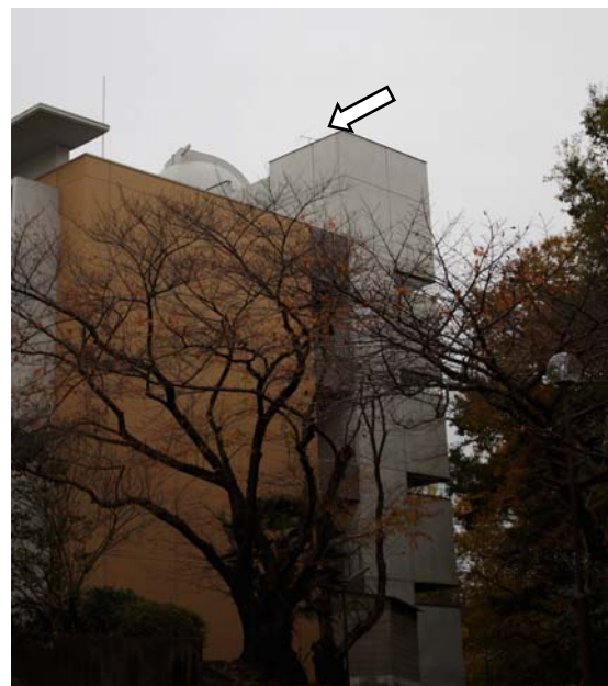
図 4 明星大学 30 号館 天体ドーム横の屋上スペースに設置したアンテナ
